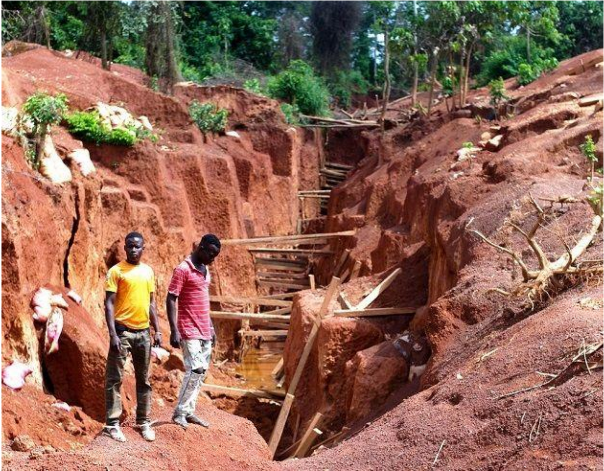
Figure 2 : Le fragile étayage de la mine 22, Côte d'Ivoire, octobre 2015 © @Benjamin Chauvin/RF - @Benjamin Chauvin/RF
